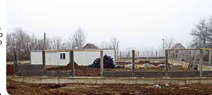
Kolektor za pročišćavanje
